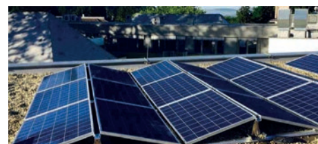
PV Wohnen am Kurpark (2017) 16kW im Zentrum von Bad Gleichenberg
