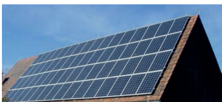
PV Attendorf Wenzl (2014), 16kW auf privatem Nebengebäude mit 100% Bürgerbeteiligung
