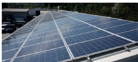
PV Köflach Pagger (2015), 50kW auf gewerblichem Gebäude
