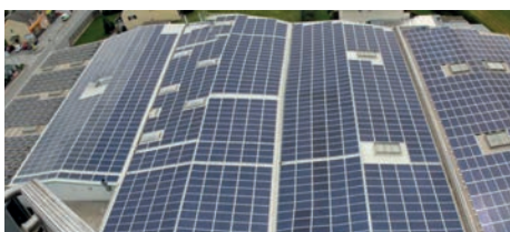
PV Weiz ÖBAU (2013), 498kW auf gewerblichem Gebäude mit Bürgerbeteiligung
